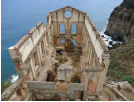
Estación de bombeo La Gordejuela, Los Realejos
